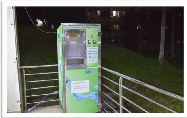
Mesin air RO
